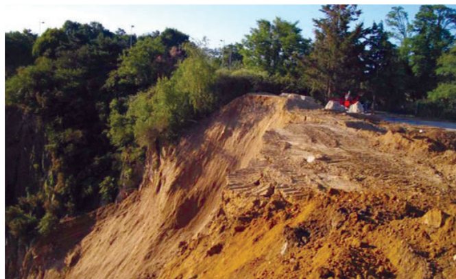
Plateforme de remblai instable
