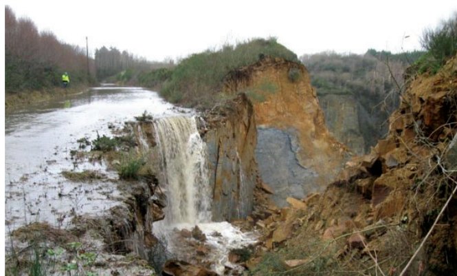
Effondrement partiel d'un front de taille sous l'effet du débordement d'un cours d'eau
